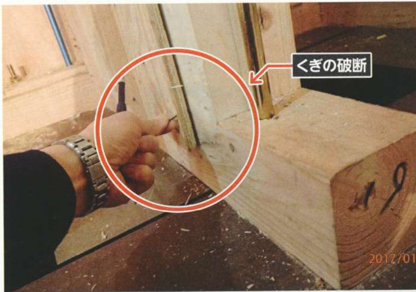
〔写真9〕 合板、金物、筋かいで損傷発生
