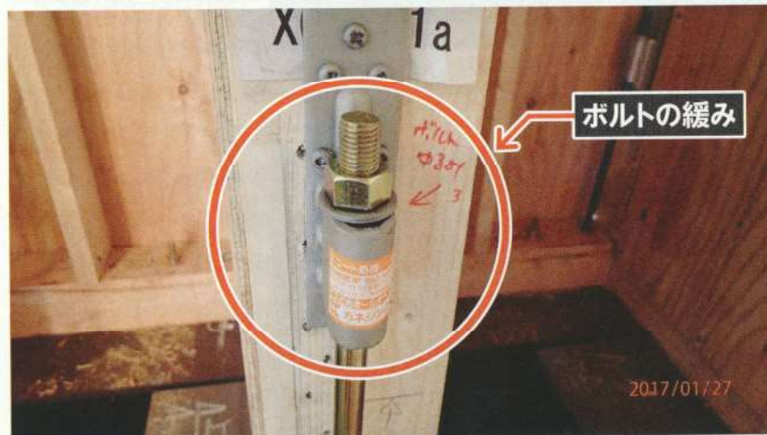
〔写真10〕柱の引き抜き力でボルトに緩み
